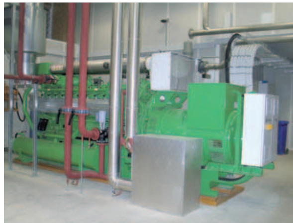
Grösstes privates Biogas- BHKW «Jenbacher» mit 1 MW Leistung in der Schweiz. Gebr. Bösch AG Herisau.
