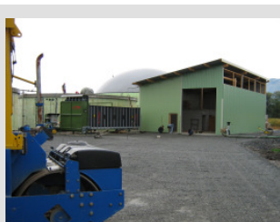
L'installation est dotée d'un hygiénisateur, un système d'introduction direct, une halle de stockage etc.
