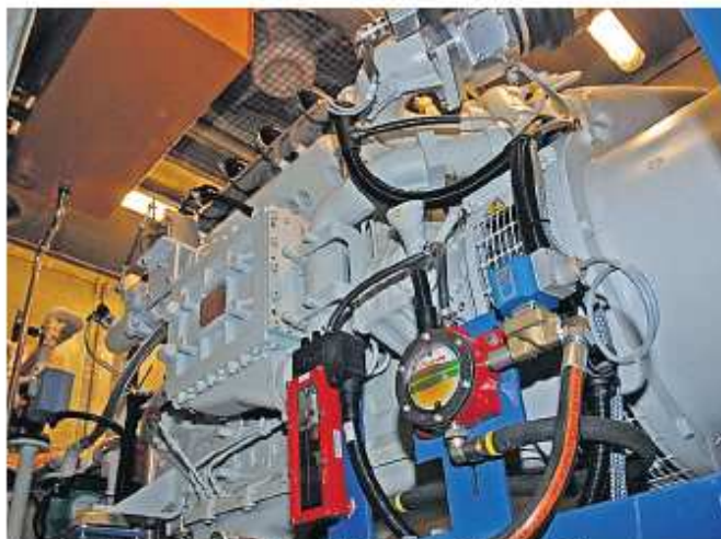
Das neue leistungsfähigere Blockheizkraftwerk in der ARA Langmatt.
