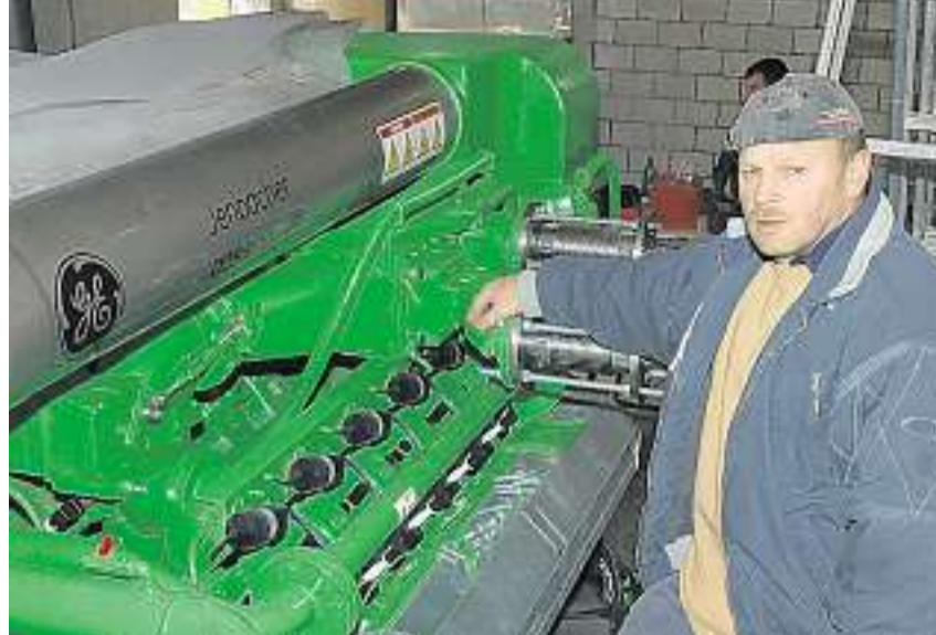
Baptist Reichmuth beim Herzstück der Biogasanlage: Zurzeit wird der Heissgasmotor installiert, in rund drei Wochen soll er erstmals laufen. Bild Andreas Seeholzer
