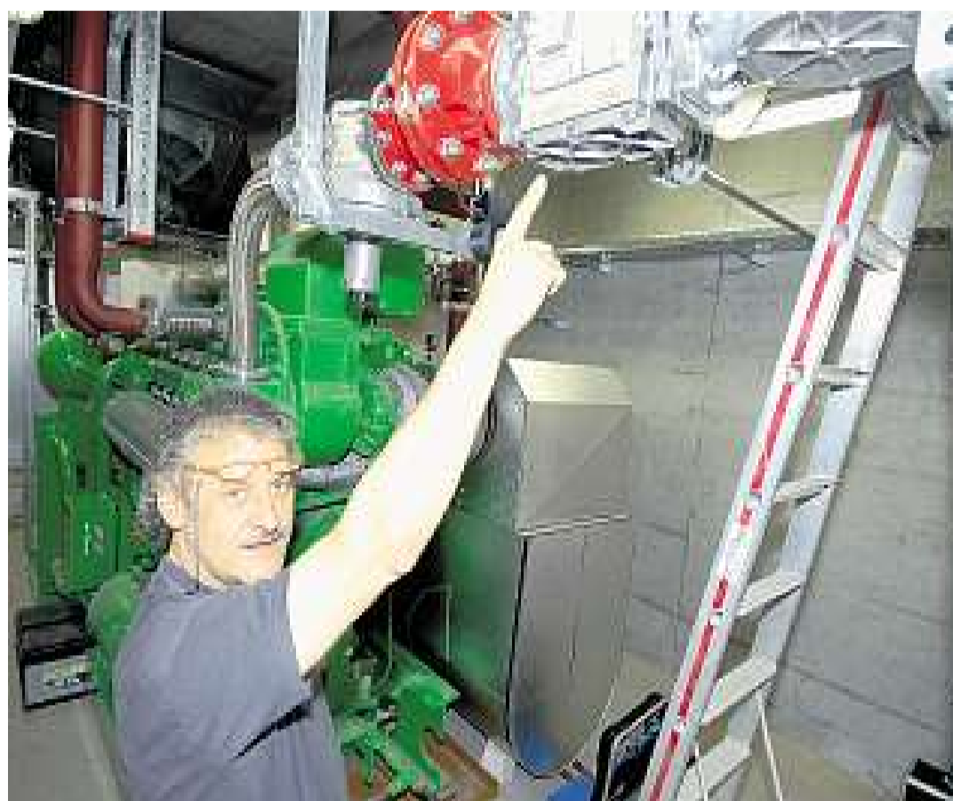
Der Biogasmotor erzeugt seit gestern Strom: Der Ingenieur Josef Egger zeigt auf die Leitung, in der dem Motor Biogas zugeführt wird. Bild Andreas Seeholzer
