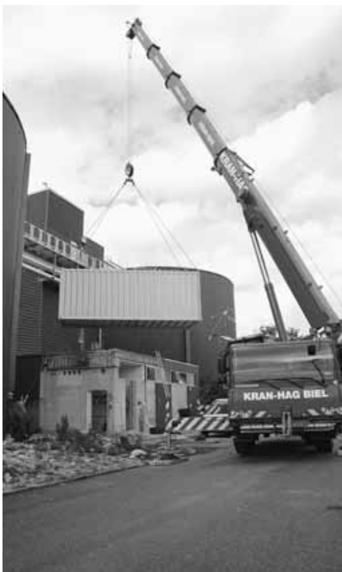
Mit dem Kran wurde die neue Anlage zur Stromproduktion gestern an ihren Platz gehievt.
